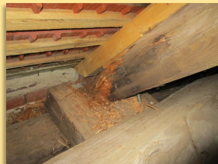
Schäden an der Dachkonstruktion
