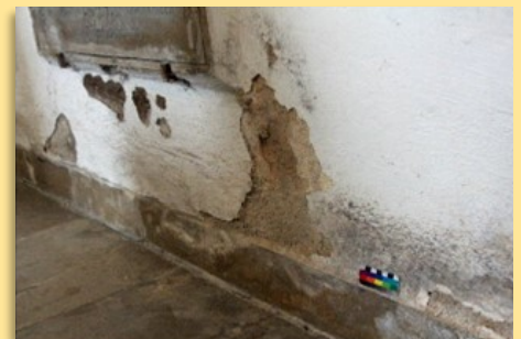
Feuchtigkeitsschäden an der Wand
